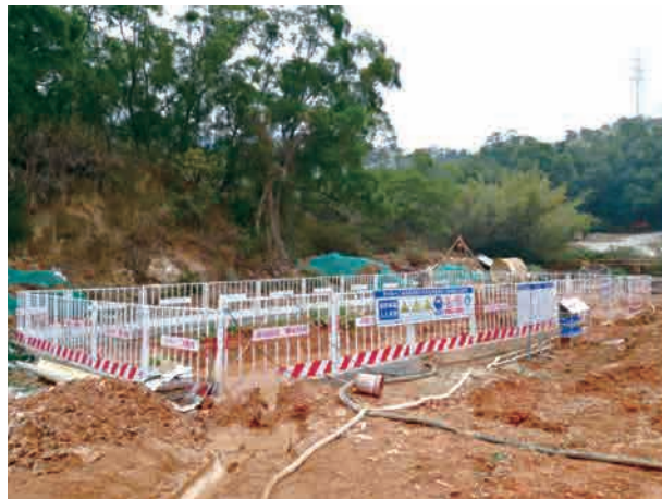
图5 泥浆池安全防护
