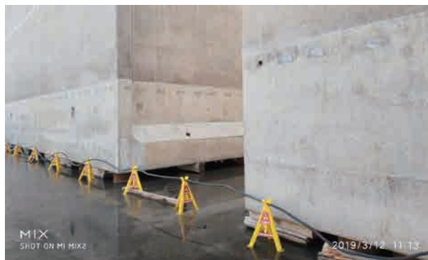
图 2-13 涉水电缆架空
