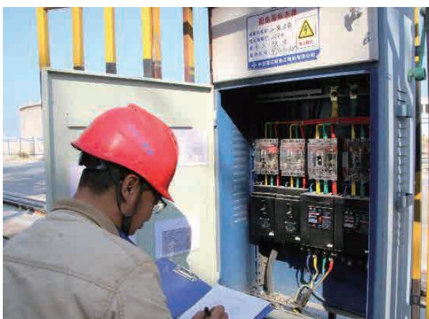
图 2-12 电工日常巡查
