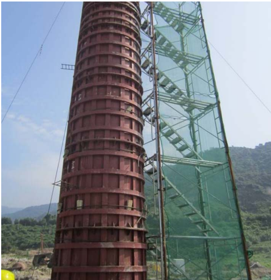
图 6.12 高墩防护：高墩施工应配备专用行人爬梯且做好临边防护；当高度超过 40 米的高墩，需考虑配备施工电梯。
